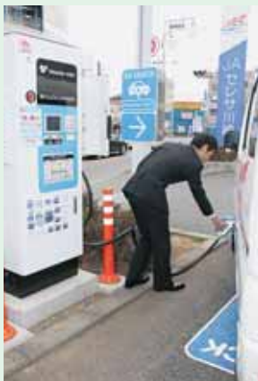
菅生支店に設置された充電器
