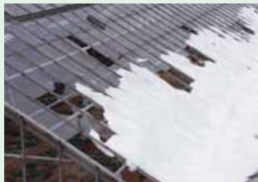
雪の重みで温室のガラスが破損
