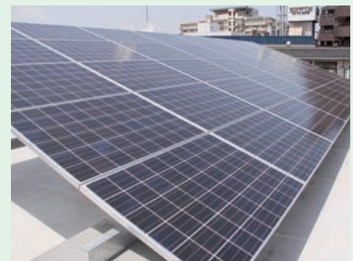
屋上にソーラーパネルを設置して太陽光発電とLED電球で省エネを実現
