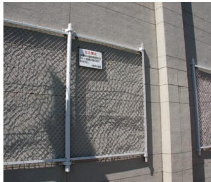
②実はこれ、テニスのボールの壁打ちをする人が多く、駐車の妨げになるために設置された、壁打ち防止の為に金網です
